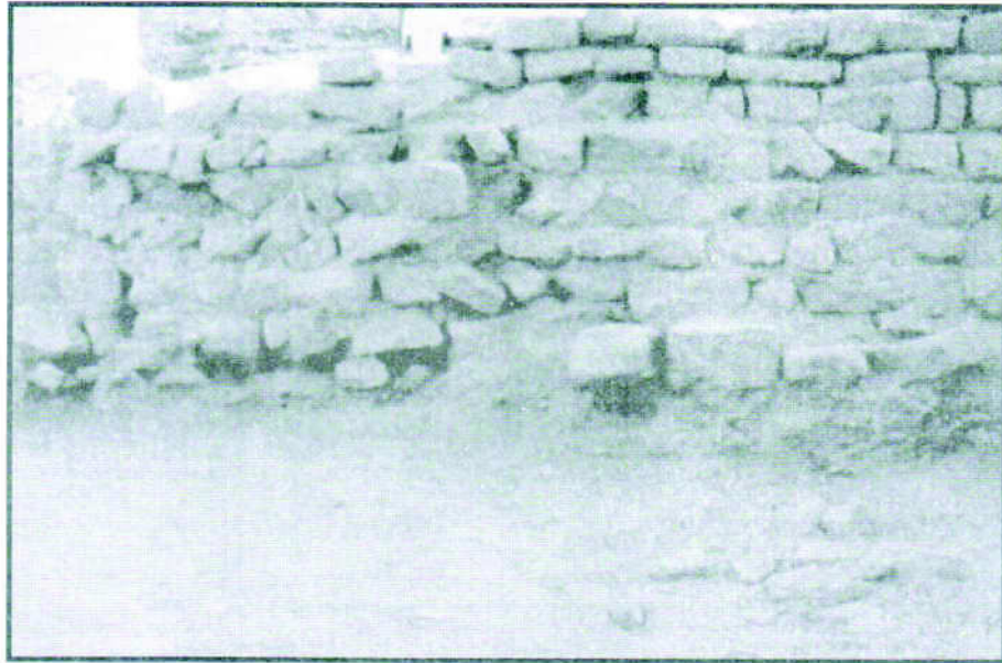
صورة رقم (٢٤) توضح كيفية سقوط الأحجار نتيجة الزلازل
