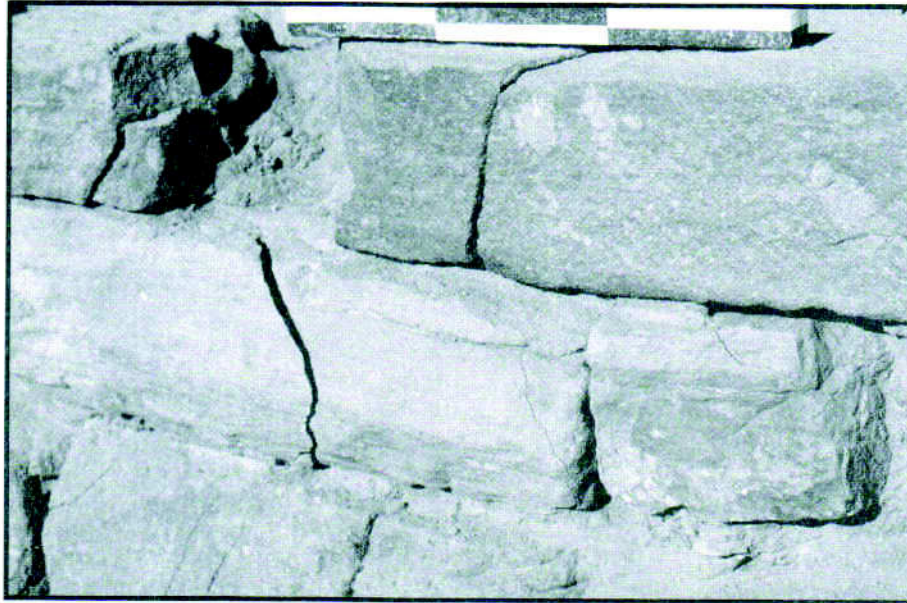
صورة رقم (٢٦) توضح كيفية سقوط الأحجار نتيجة الزلازل
