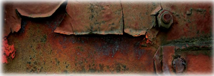
شكل (٢٢) تآكل التماس الثاني (Dissimilar Metal Corrosion)
